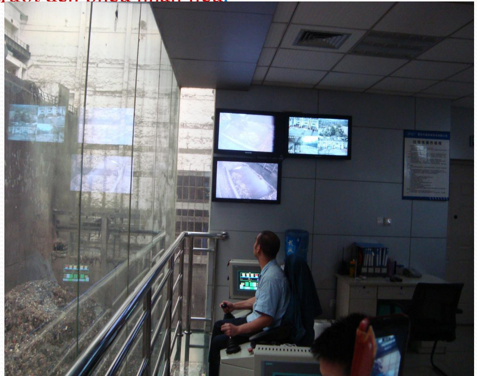
Hình ảnh thực tế về công đoạn nạp liệu trong nhà máy đốt rác phát điện công nghệ Martin
